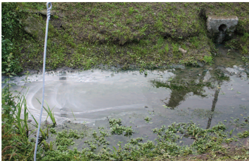
Scarico diretto di acque reflue da centro abitato in corsi d'acqua superficiali
